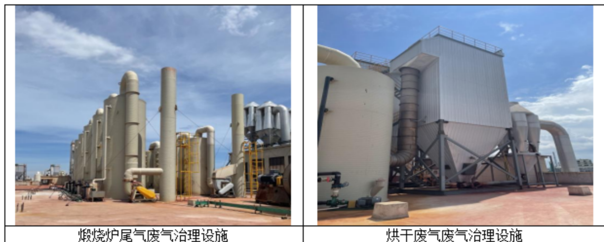
图 4.1-2 废气治理措施图片
